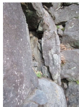
石材前面が崩落 しつつある石材
