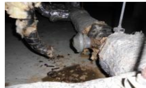
【配水管の腐食】
