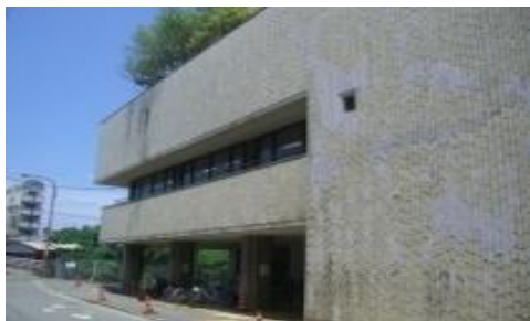
【経年劣化によるタイルの落下】
