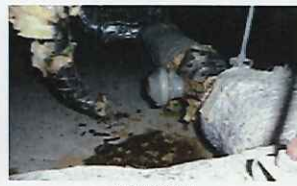
【排水管の腐食】
