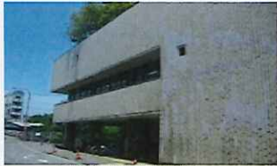
【経年劣化によるタイルの落下】
