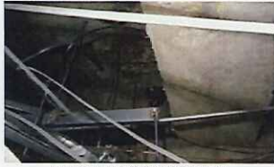
【コンクリート部分の劣化による雨漏り】
