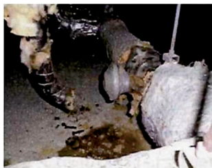
配水管の腐食
