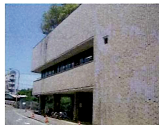
経年変化によるタイルの落下
