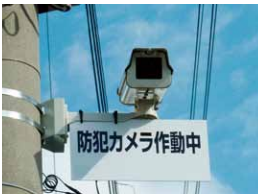
防犯カメラの設置
