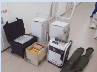
非常用親局設備
