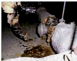
配水管の腐食
