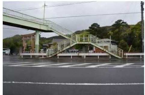
紀州東照宮前の老朽化した歩道橋
