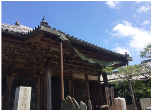
阿弥陀寺本堂(旧紀伊藩台徳院霊屋) ・平成30年8月 国重要文化財(建造物)指定 ・9月台風21号被害(雨樋・屋根瓦) →管理補助事業(小修理)
