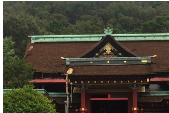
国重要文化財(建造物) 東照宮拝殿・石の間・本殿 ・平成30年9月台風21号被害 →修復整備事業
