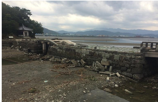
平成30年9月台風21号文化財被害状況 名勝和歌の浦(三断橋)
