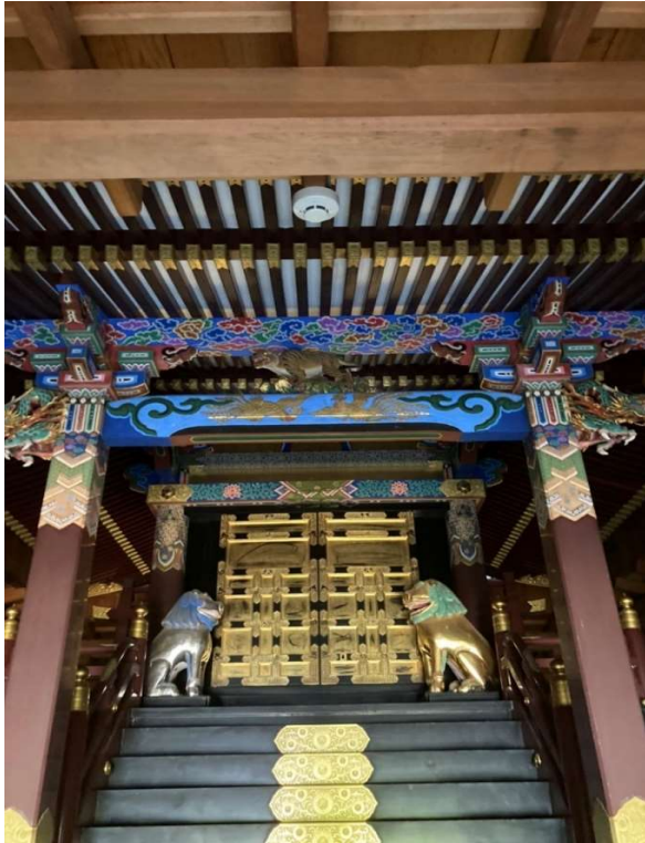
本殿煙感知器
