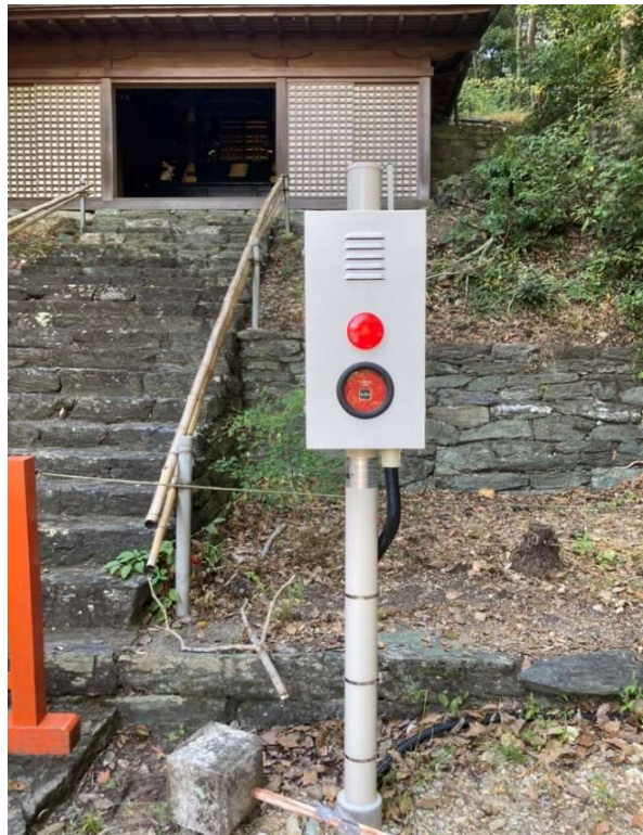
押しボタン式火災報知器
