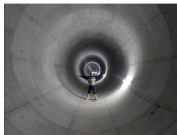
松島本渡線の地下に 敷設されている雨水貯留管
