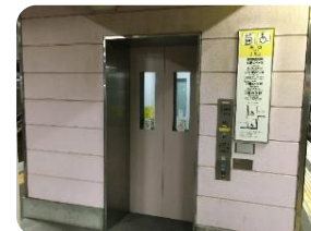
エレベーター
