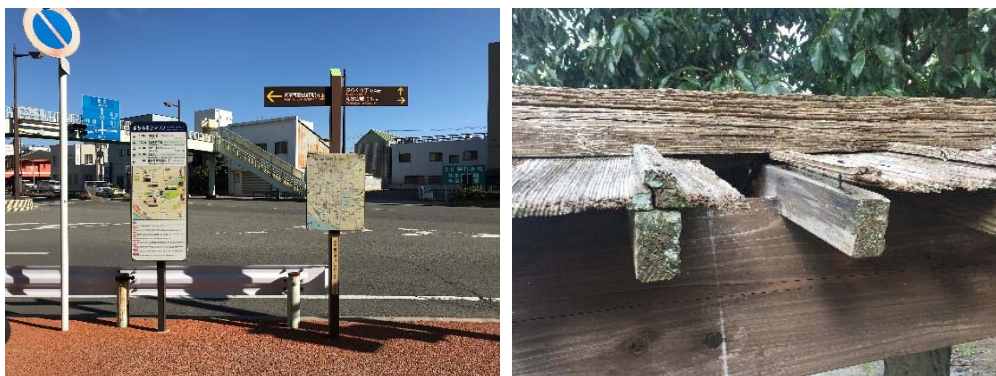
写真 3-1 左:類似する案内サインが複数設置 右:経年劣化した躯体
