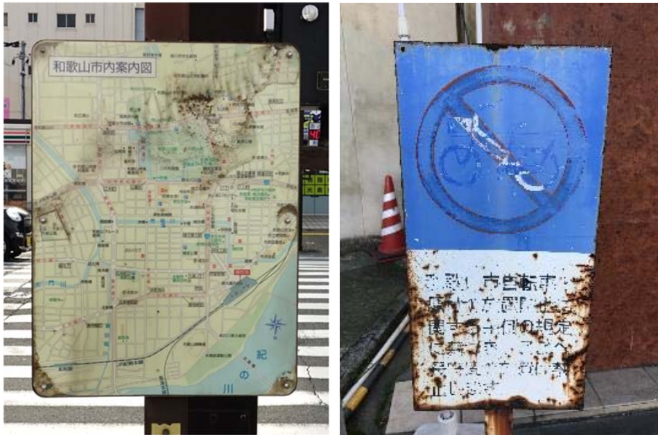
写真 3-2 左：雨水等によって変色したサイン 右：錆びによって劣化したサイン
