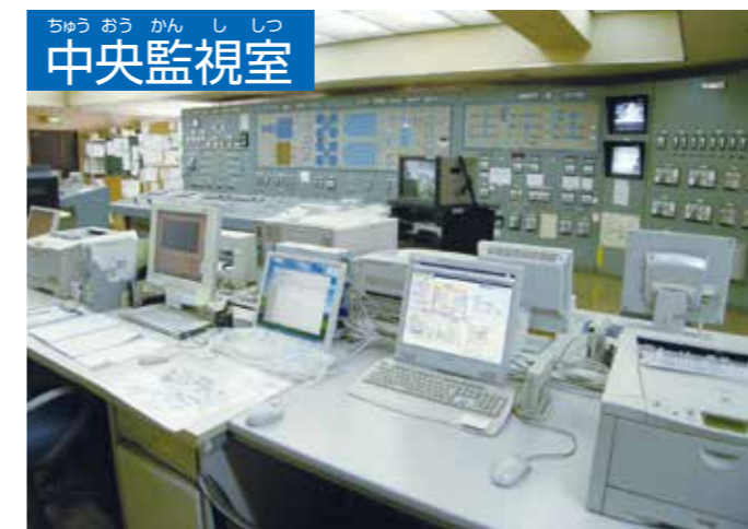
中央監視室 浄水場の機械の動きを調節し、異常がないか24時間監視します。
