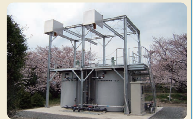
粉末活性炭注入設備(出島浄水場)
