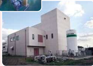
消石灰・炭酸ガス注入設備
