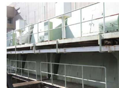
老朽化した沈砂池設備(大淀雨水ポンプ場)
