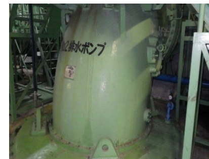
老朽化したポンプ設備(新堀雨水ポンプ場)
