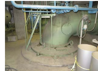
老朽化したポンプ設備(大淀雨水ポンプ場)
