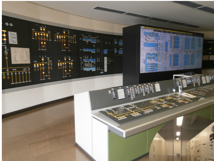
▲中央監視操作室
