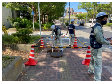
マンホール蓋飛散の緊急措置状況
