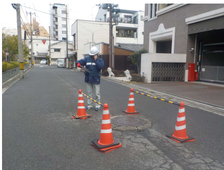
マンホール蓋飛散時の緊急措置状況
