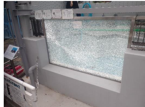
(4面あるガラス面のうち1面が破損)
