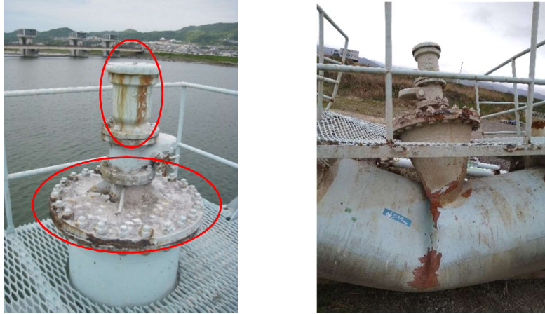
図－9 空気弁（左：既設空気弁 右：落橋後の空気弁）
