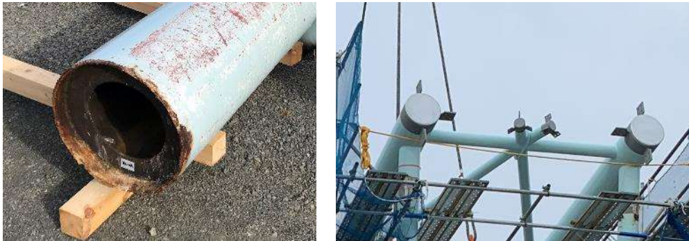
図-7 落橋アーチ材破断部と新設アーチ材ダイヤフラム
