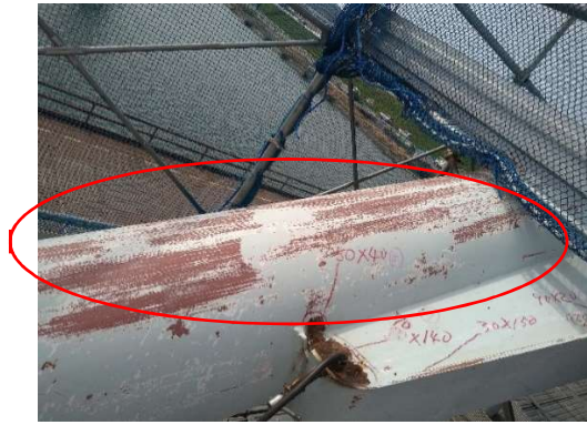
図-10 塗装の劣化状況
