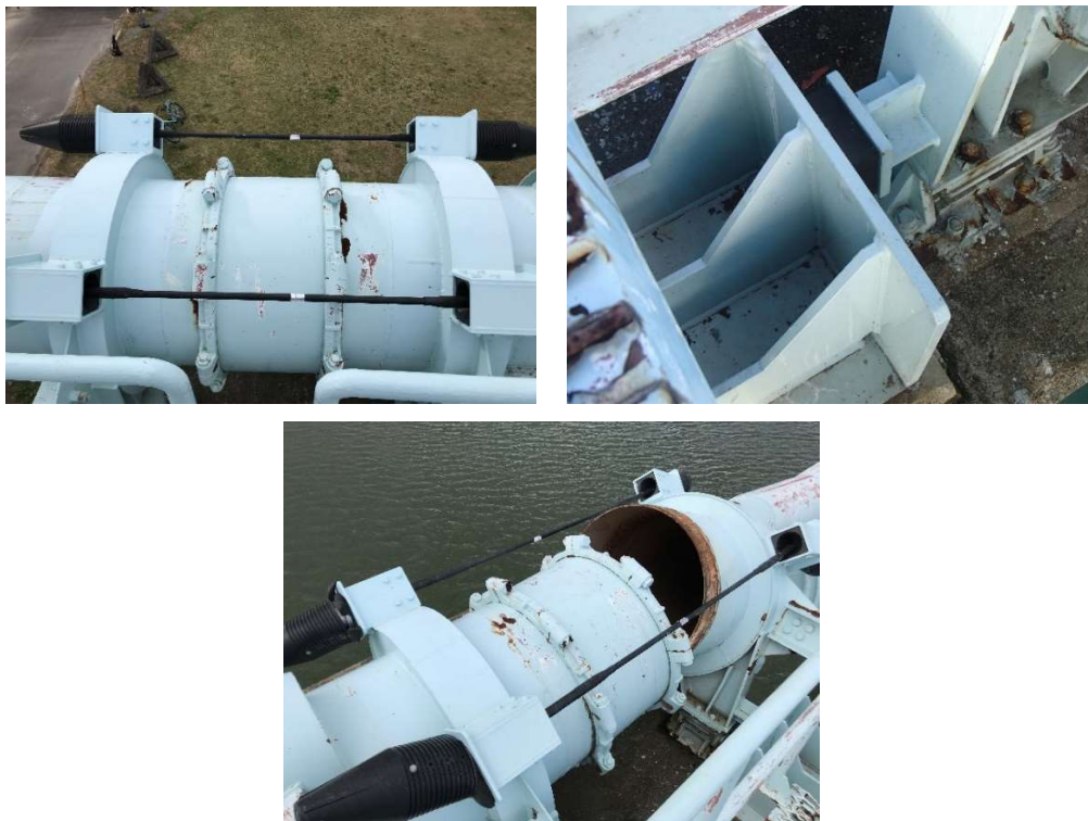
図-11 落橋防止装置（左：橋軸方向 右：橋軸直角方向 下：落橋後）
