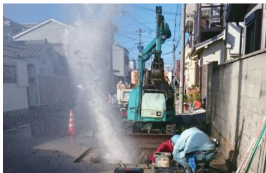
経年化による漏水状況①
