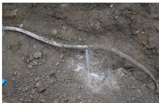
鉛製給水管の漏水状況
