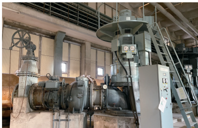
揚水ポンプ設備
