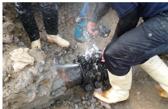
経年化による漏水状況②
