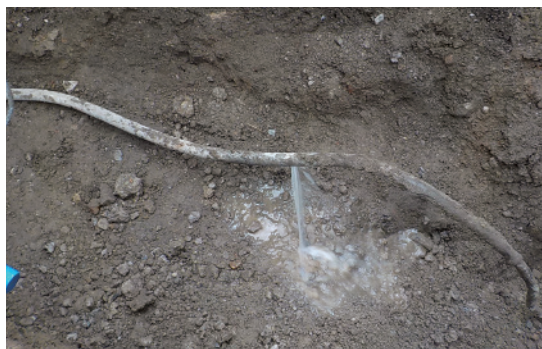
鉛製給水管の漏水状況
