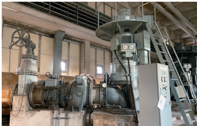
揚水ポンプ設備
