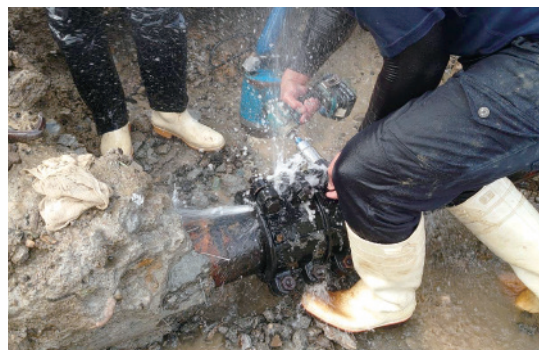
経年化による漏水状況②
