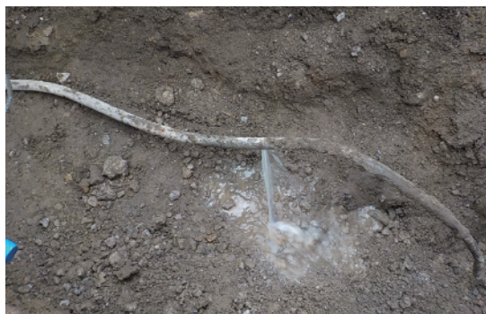
鉛製給水管の漏水状況
