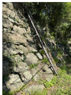
和歌山城石垣配管状況
