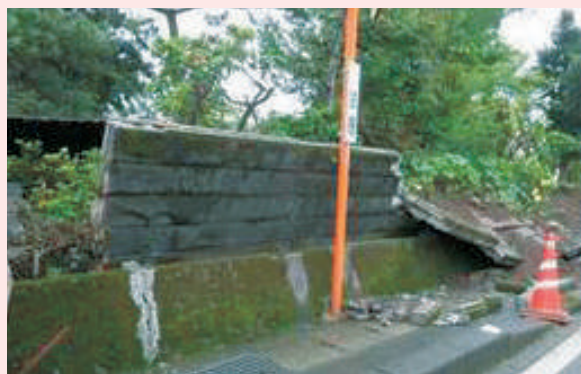
道路に面した危険なブロック塀
